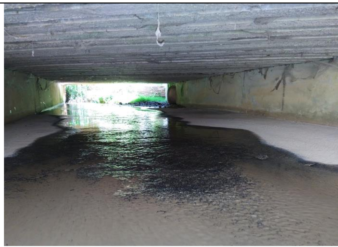
Etat de l'intrados du tablier
