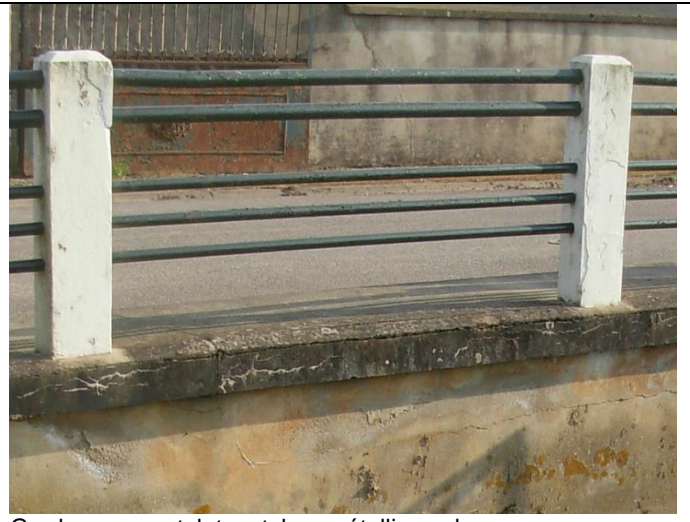
Garde-corps potelets + tubes métalliques hors normes
