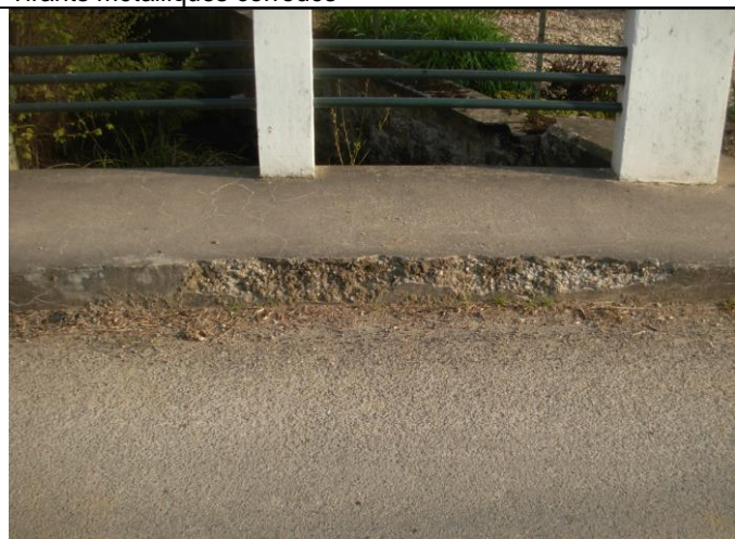
Epaufures et éclats des bétons de trottoirs
