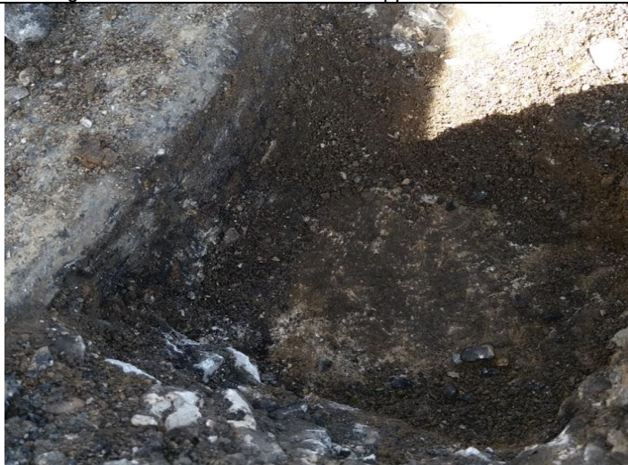
Sondage indiquant l'absence d'étanchéité
