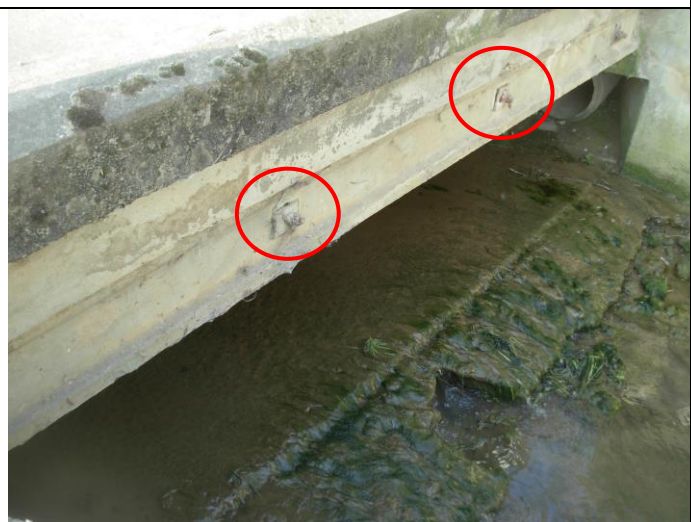
Tirants métalliques corrodés
