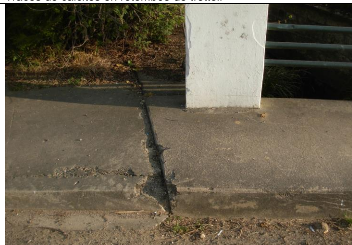
Léger tassement en about de trottoirs
