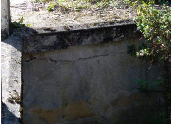
Fissurations apparentes sur mur en ailes
