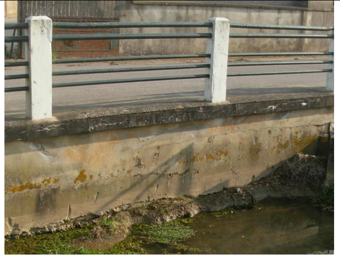
Fissurations et éclats de béton sur mur en retour
